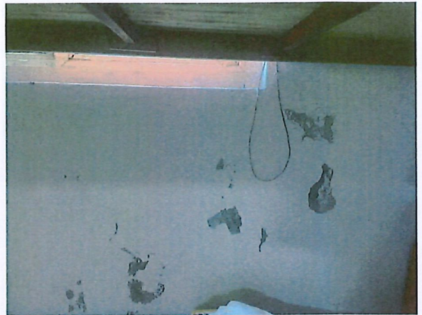
活動中心女籃宿舍牆壁油漆剝落
