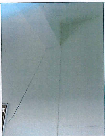
特教辦公室木板隔間壁面裂紋
