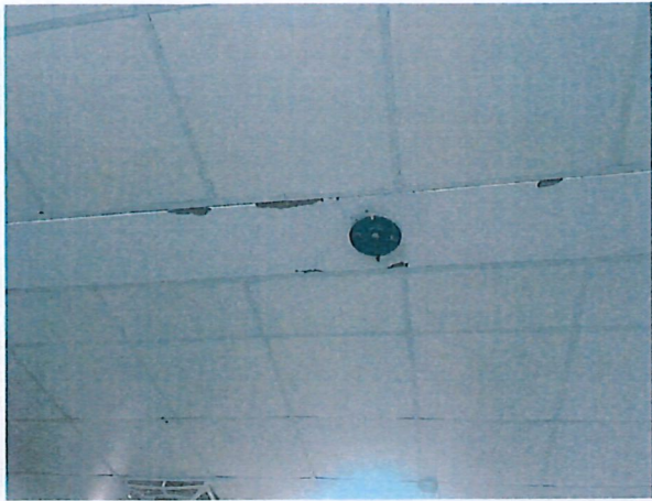
活動中心女籃宿舍天花板油漆剝落
