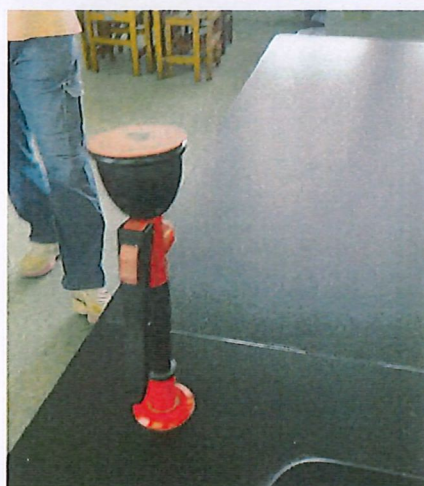
生物教室洗眼器請設備組檢修
